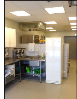
Lysrør i himling i kjøkken
