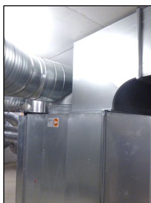
Fordelingskanal med spjeld
