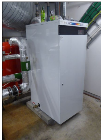
Fortsatt bruk av eksisterende el-kjel
