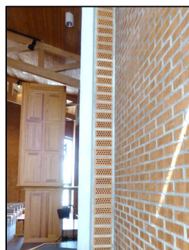
Tilluft gjennom hull i teglstein
