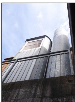
Hoved luftinntak og -avkast
