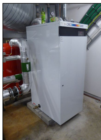
Fortsatt bruk av eksisterende el-kjel
