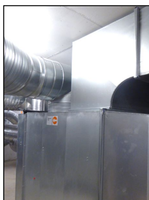
Fordelingskanal med spjeld
