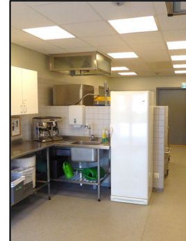
Lysrør i himling i kjøkken
